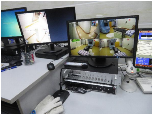
图 3-5 直加控制室内视频及对讲设备
