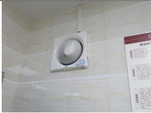
图 3-20 CT 机房排风口
