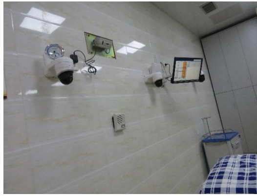
图 3-4 直加机房内视频及对讲设备
