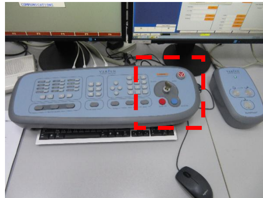
图 3-6 控制室内紧急按钮
