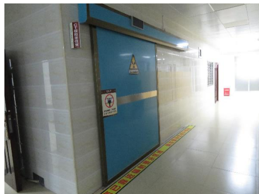
图 3-18 受检人员出入 CT 机房防护门
