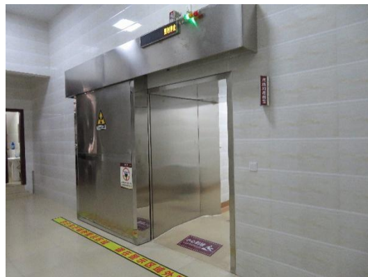
图 3-2 直加机房防护门
