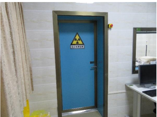
图 3-17 控制室出入 CT 机房防护门
