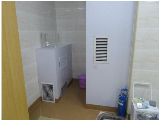
图 3-3 直加机房内排风柜
