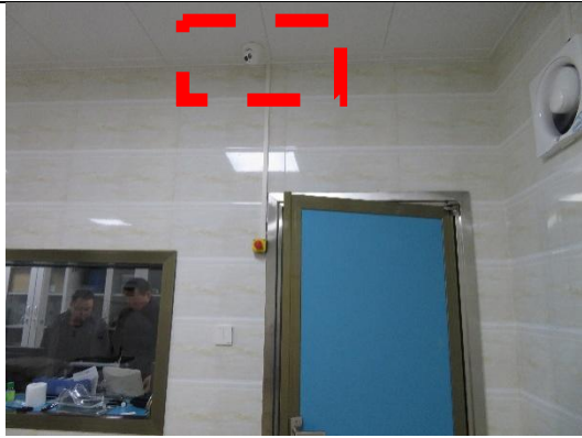
图 3-19 CT 机房内东侧墙上监控设备
