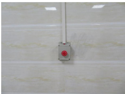
图 3-3 机房内紧急按钮
