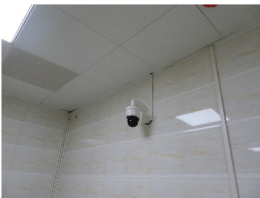
图 3-4 机房内视频设备
