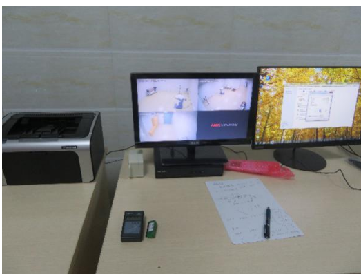
图 3-6 控制室内视频监控
