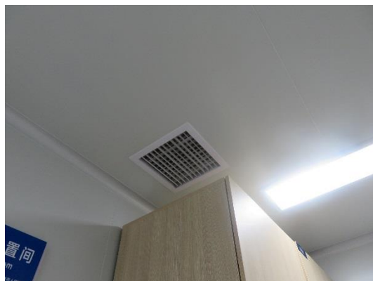
图 3-6 机房内排风口
