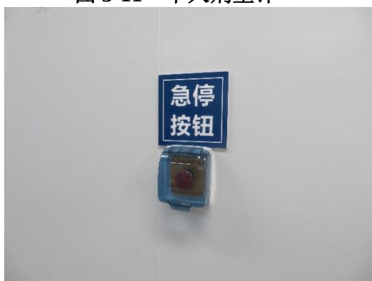
图 3-13 机房内紧急停机开关
