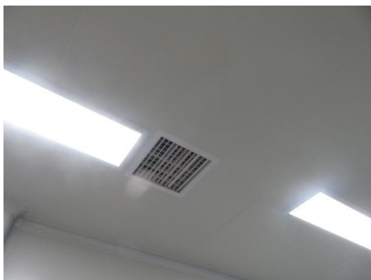
图 3-7 机房内排风口
