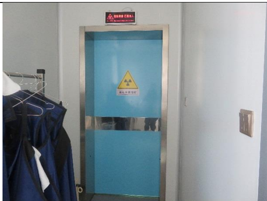
图 3-3 控制室出入机房防护门
