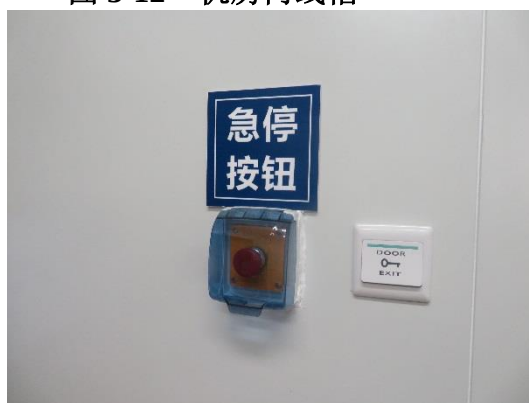
图 3-14 机房外紧急停机开关
