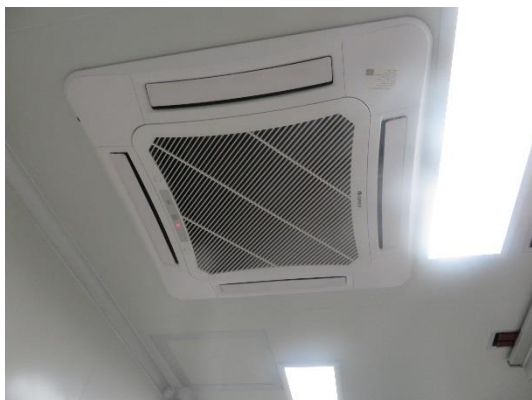
图 3-5 机房内送风口
